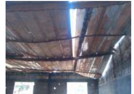
Le toit de l'école en triste état
