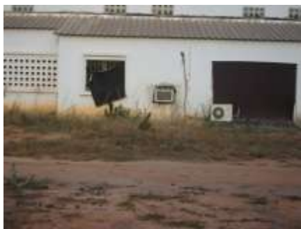
état de délabrement bâtiments
